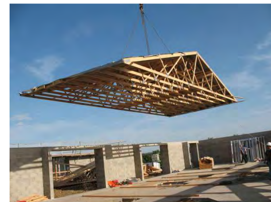
Photo 4 : Charpente industrialisée, ARBONIS
