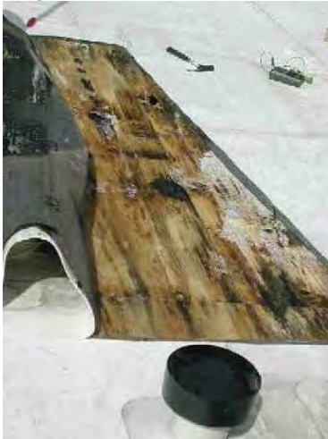
Photo 10 : Infiltration d'eau derrière le pare-pluie, WIGWAM Conseil
