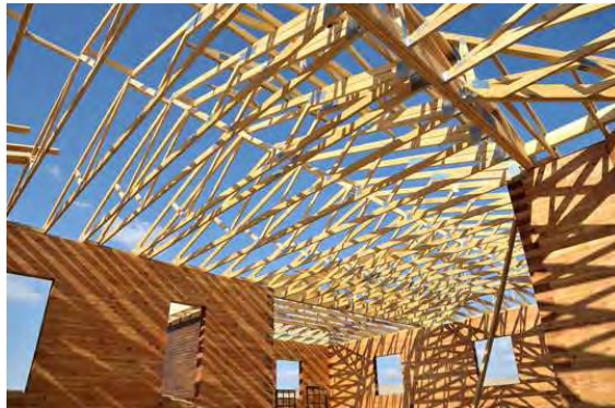
Photo 2 : Charpente industrialisée, ARBONIS
