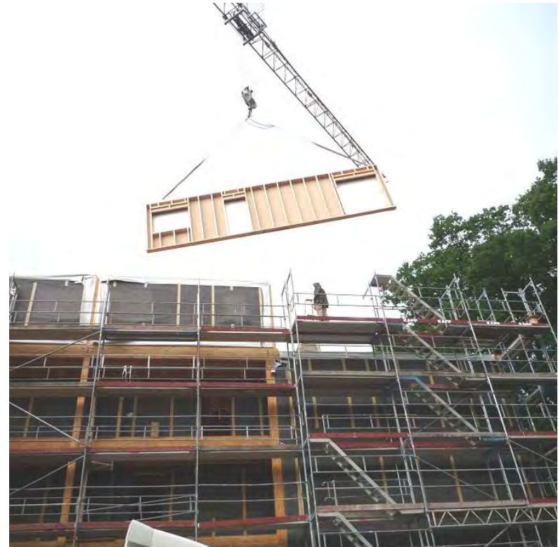
Photo 27 : Structure poteau poutre bois et façades panneaux d'ossature bois, MOA : SA Le Toit Vosgien (88)
