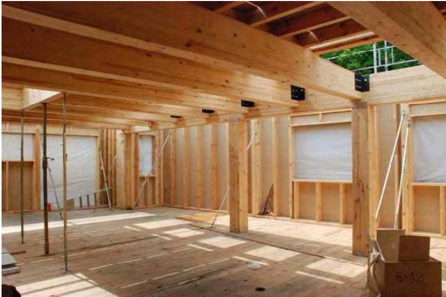
Photo 28 : Structure poteau poutre bois, façades panneaux d'ossature bois et plancher panneaux bois massif, MOA : SA Le Toit Vosgien (88)
