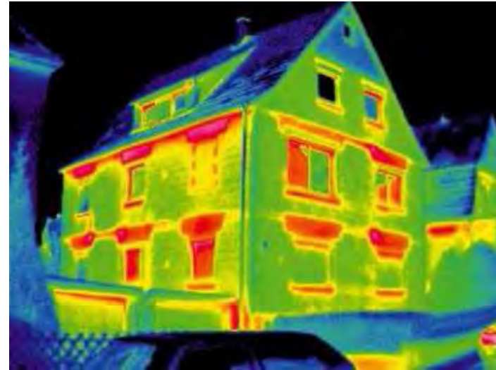
Photo 8 : Ouvrage et ponts thermiques
