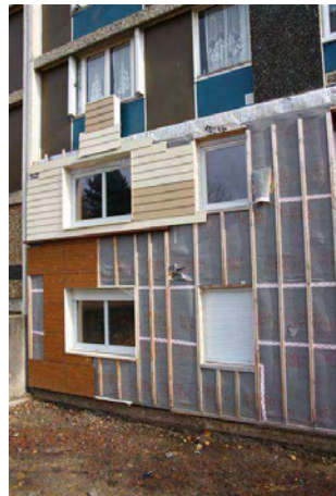
Photo 12 : Isolation en panneaux de fibre de bois sur un immeuble, MOA OPH AUTUN Habitat
